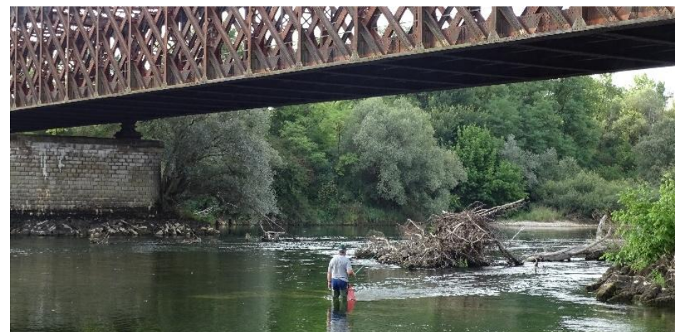
Figure 36 : Embâcles sur le Doubs à Chaussin (Pont de Peseux)
