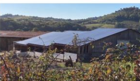
Vesely, panneaux photovoltaïques sur toiture. Espace François Bonnet (MHI - OUV MHI)
