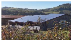
Vesvry - panneaux photovoltaïques sur toiture. © Jean-François Biond (AEP - DRAE BFC)
